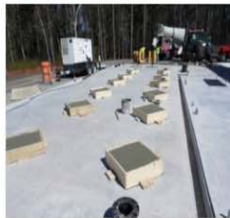
Filter tank pads 1.JPG
